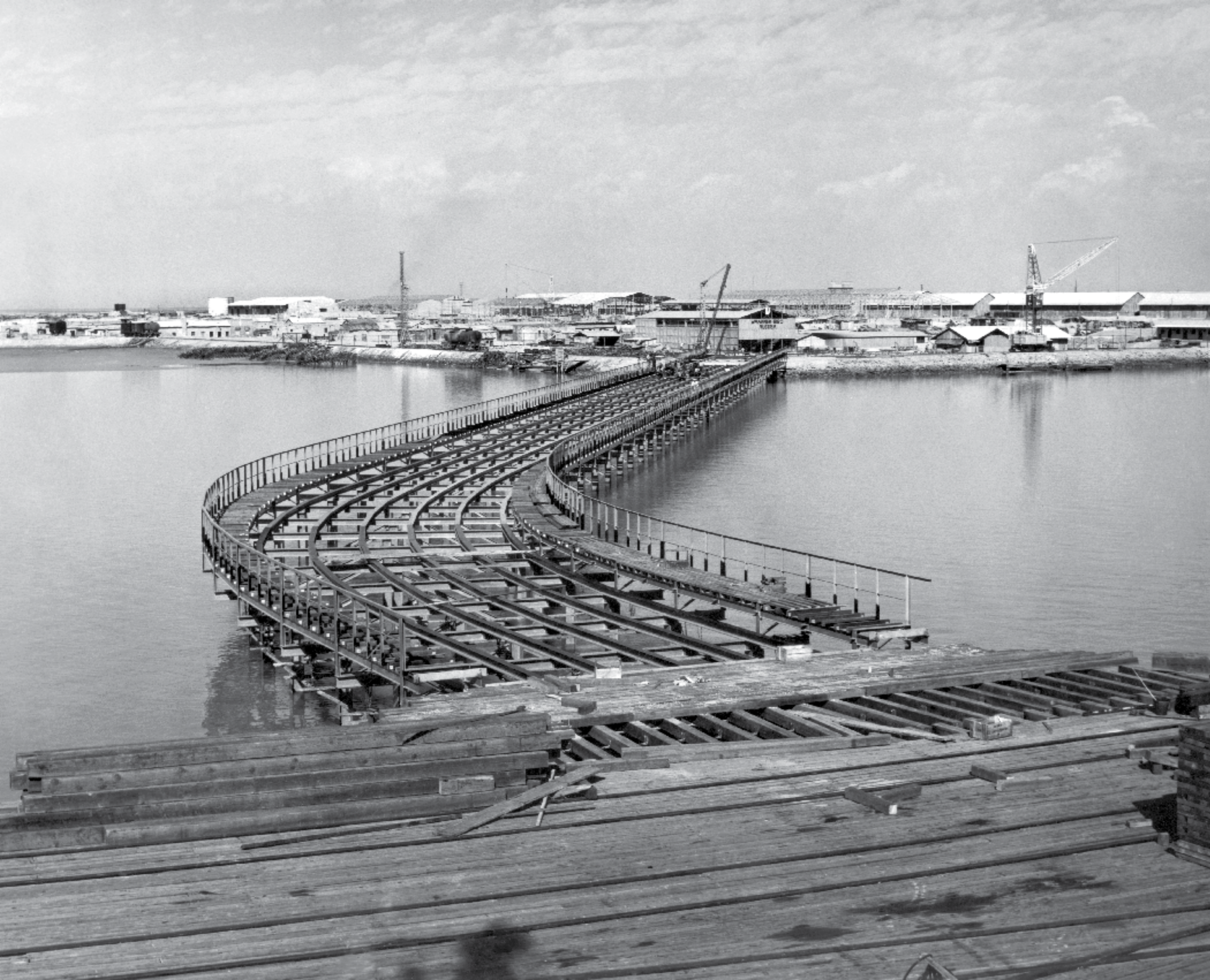
اسکله‌های جدید فیلیه (بعد از اسکله‌های چهارده و پانزده)، ۱۳۵۲. عکس از: آرشیو کیهان آرشیف صحیفه کیهان میناء - اوائل عقد ۱۹۶۱ - الصورة من آرشیف وكالة أنباء إرنا New Feilieh Jetties (after jetty No.s 14 and 15), 1973, photo from Keyhan archive
